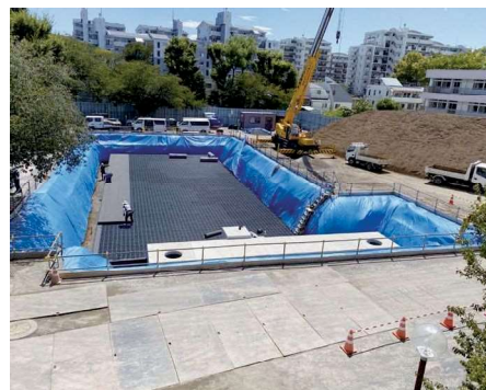
図 9 雨水貯留浸透施設 (桜野小)
