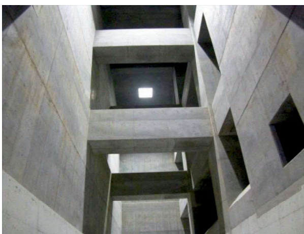
図 8 合流改善施設 (東町一丁目)
