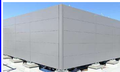
▲屋外設置 遮音パネル外観
