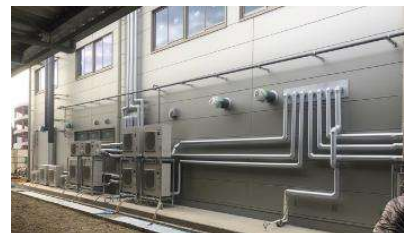
▲屋外露出 給排水配管外観②
