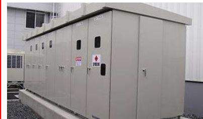
▲屋外設置 電気機器(受変電設備)
