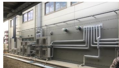
▲屋外露出 給排水配管外観②
