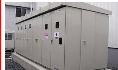
▲屋外設置 電気機器(受変電設備)
