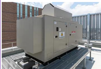
▲屋外設置 非常用発電機増設
