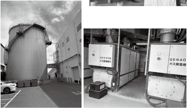
食品廃棄物の排水を貯めた発酵槽(左)。発酵槽で発生したメタンガスで電力をつくるガスエンジン(右)。
